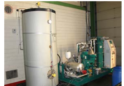
Teil der Heizanlage Altspeisefette
