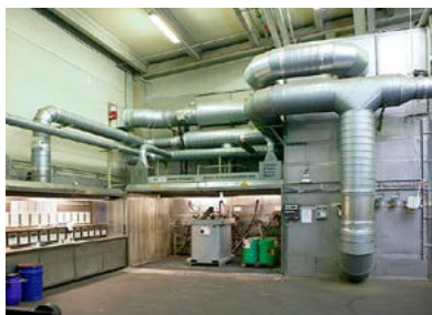
Filteranlage und Sortierstationen
