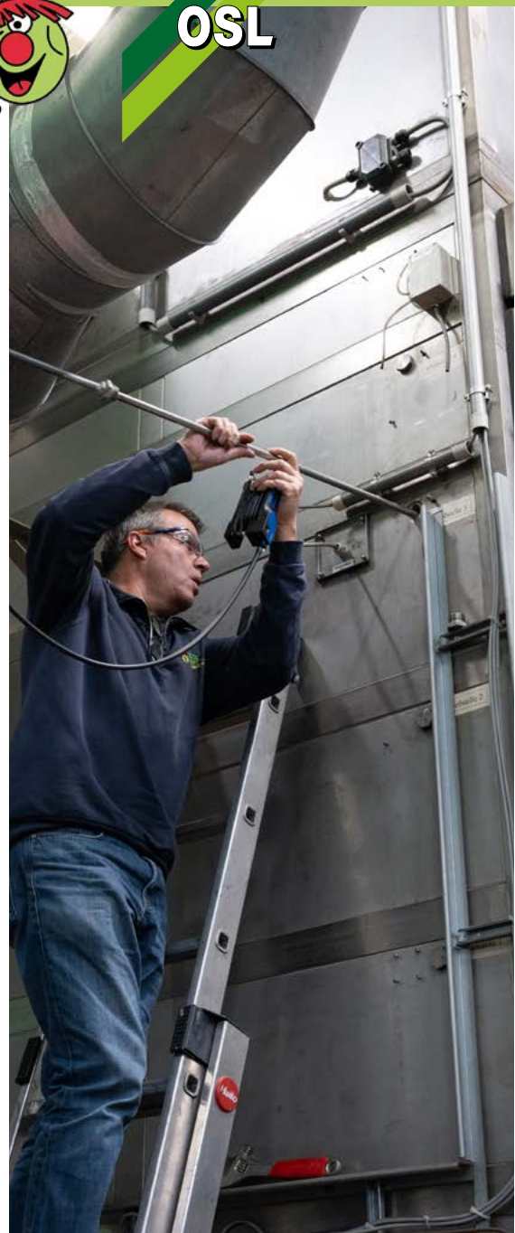
↑ Messung am Filterturm
