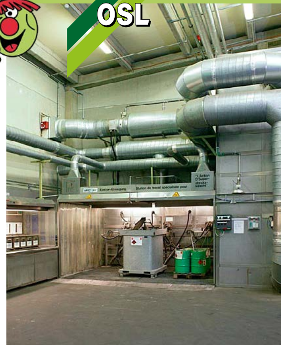
↑ Sortier- und Umfüllstation mit Filteranlage und kontinuierlicher Emissionsüberwachung
