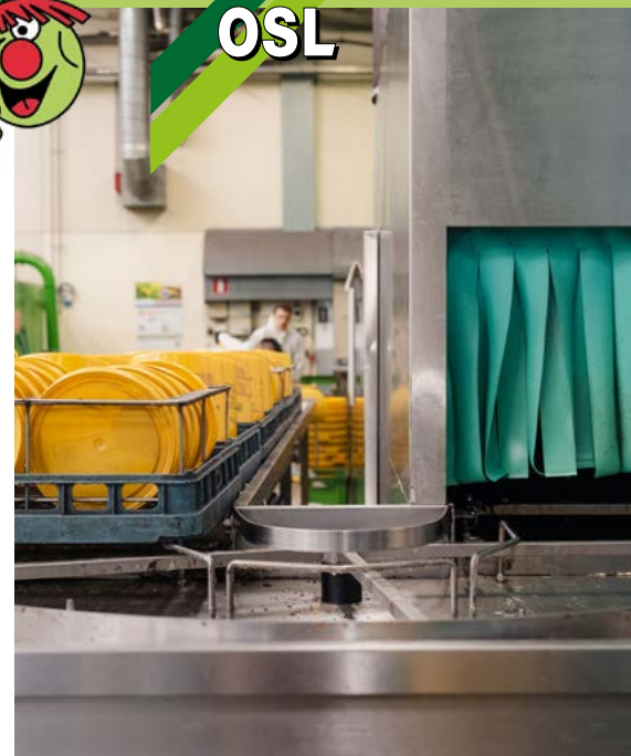
↑ Ligne de lavage des conteneurs de graisses alimentaires usagées
