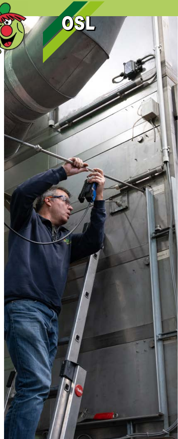
↑ Messung am Filterturm
