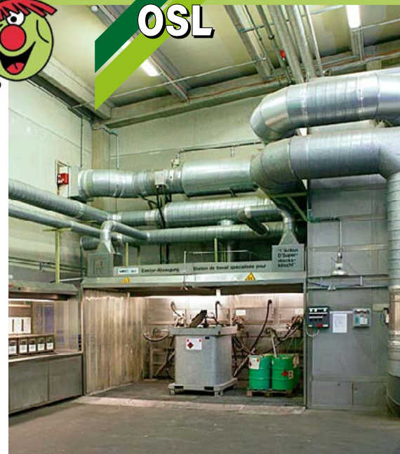
↑ Sortier- und Umfüllstation mit Filteranlage und kontinuierlicher Emissionsüberwachung
